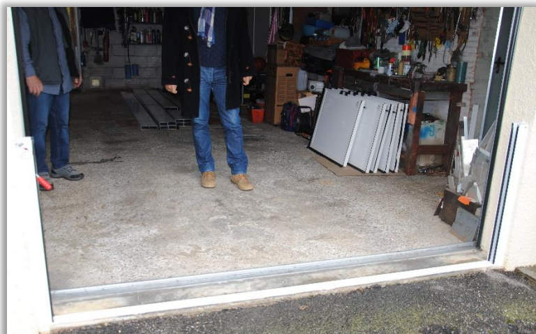
Batardeaux équipés à la suite du diagnostic
