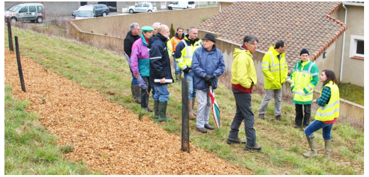
Élus, partenaires techniques et financiers ont constaté l'avancée des travaux avec les propriétaires et exploitants planteurs à l'occasion d'une visite de chantier le 16 mars 2016
