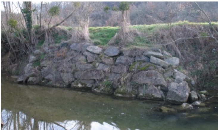
Enrochement contourné et déstabilisé à Artigat
