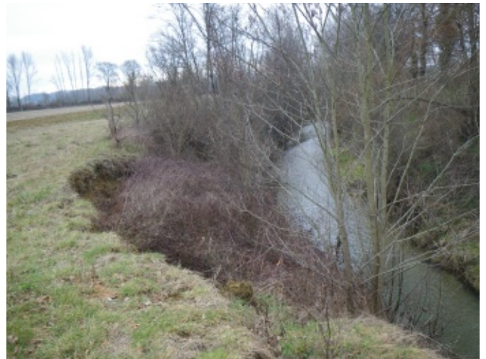
Glissement de berge, Le Fossat
