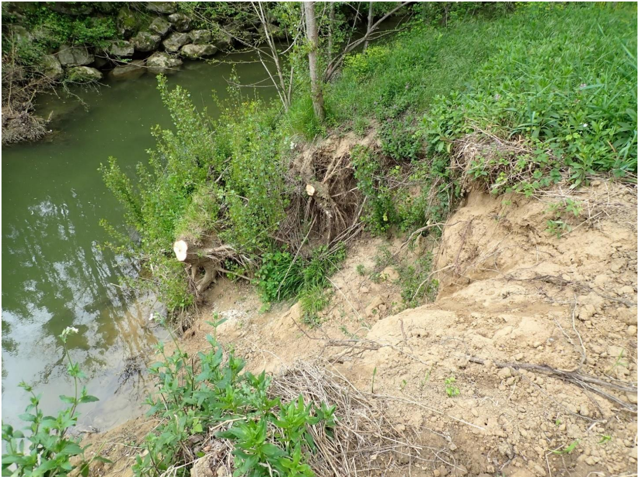
Figure 21: Erosion externe en amont du pont de la RD626A
